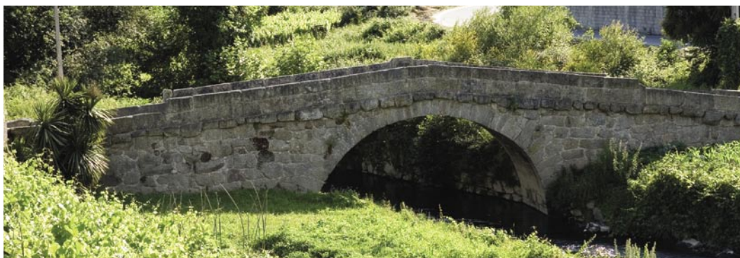
2. A Ponte de Espindo é constituída por um só arco apoiado em pilares que arrancam directamente das margens.
