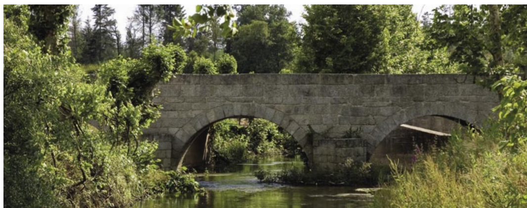
1. Na Ponte de Vilela os arcos apoiam-se em três pegões reforçados com talhamares triangulares, a montante.
