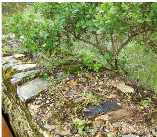
Desenvolvimento de plantas superiores, líquenes e musgos e consequente degradação dos muros.
