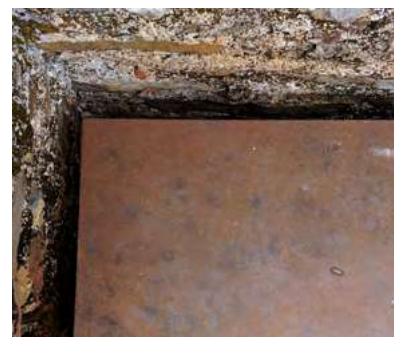
Pavimento desligado da antiga estrutura.
