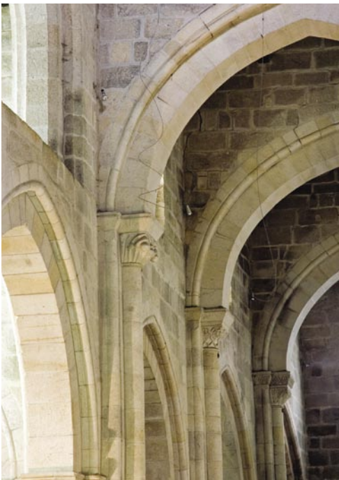
12. A utilização dos arcos-diafragma na cobertura das naves é uma solução que recorda a compartimentação do espaço nas igrejas pré-românicas peninsulares.
